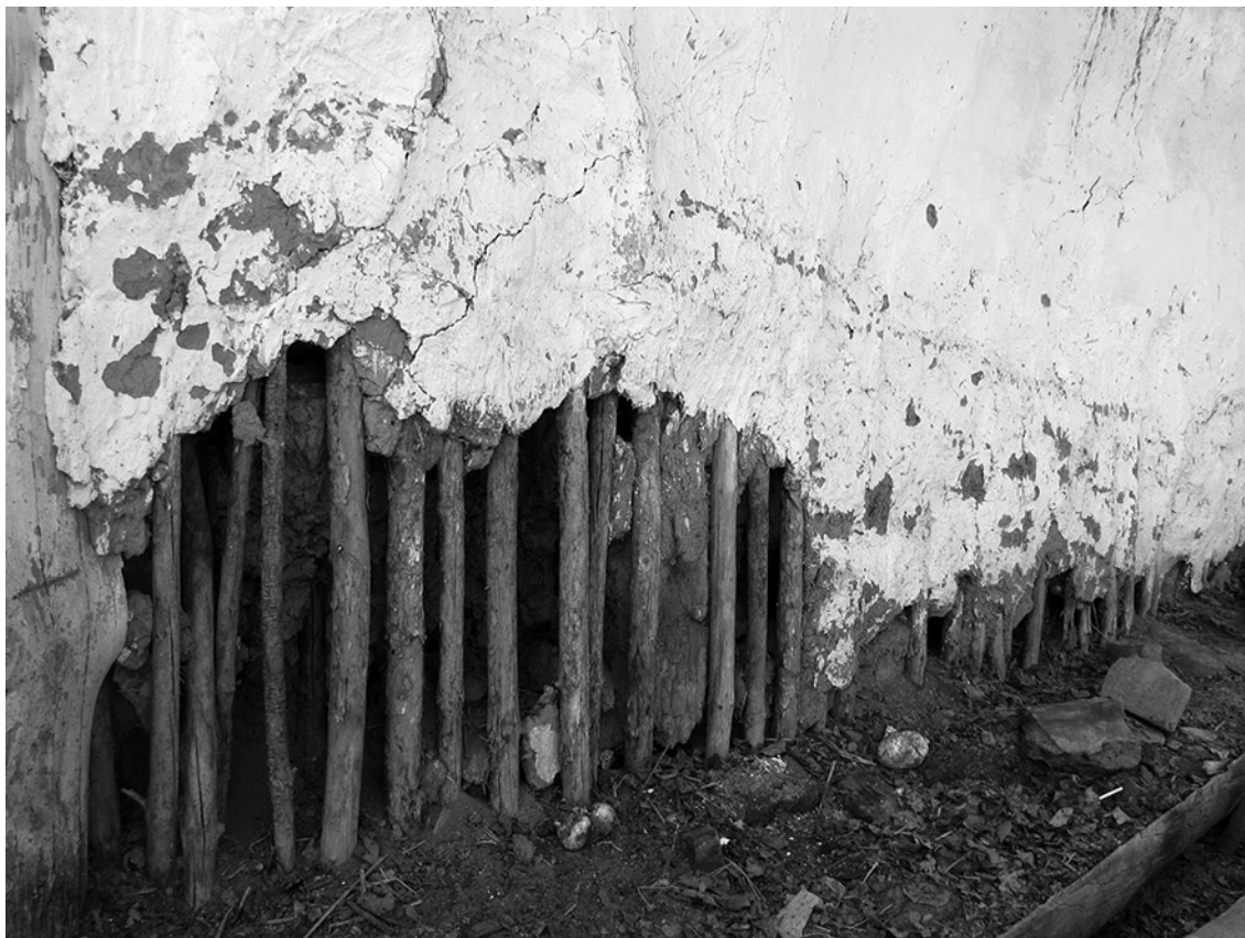
Рис. 3. «Дом в кольях». Егорьевский р-н, с. Лебяжье, ул. Советская, 110. Фрагмент нижней части стены с высыпавшейся глиной. Фото автора.
